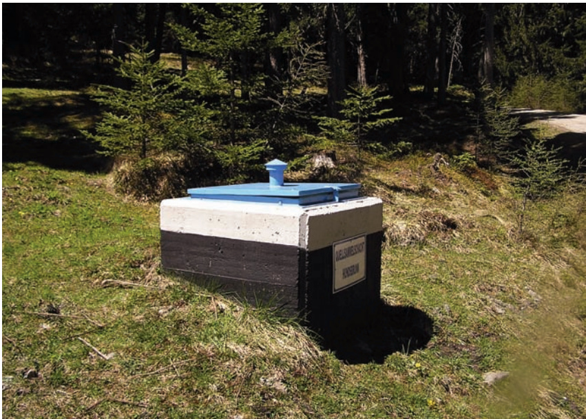
Abb. 17: Quellsammelschacht aus Beton, © AGES
