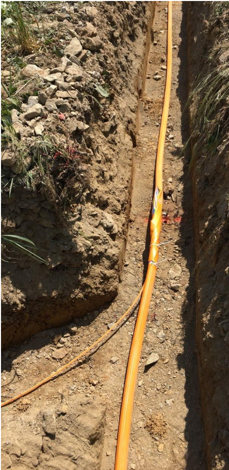
Kabelverbund in Trasse mit Hausabzweiger
